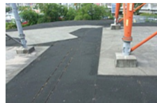
平成22年12月 周辺には雑草が繁茂しているが敷設場所には雑草は生えていない。
